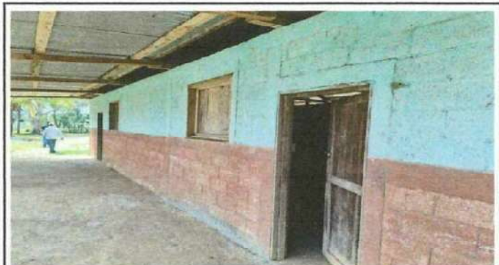
Foto 3: CUBIERTA DE LAMINA Y ESTRUCTURA DE TECHO EN DETERIORO DE LA MADERA, Y PINTURA EN LOS MUROS EXTERIOR
