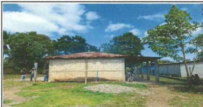
Foto 1: CUBIERTA DE LAMINA EN MAL ESTADO
