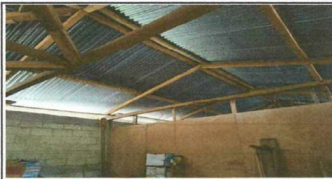
Foto 2: ESTRUCTURA DE MADERA, SE SUSTITUIRA POR METAL
